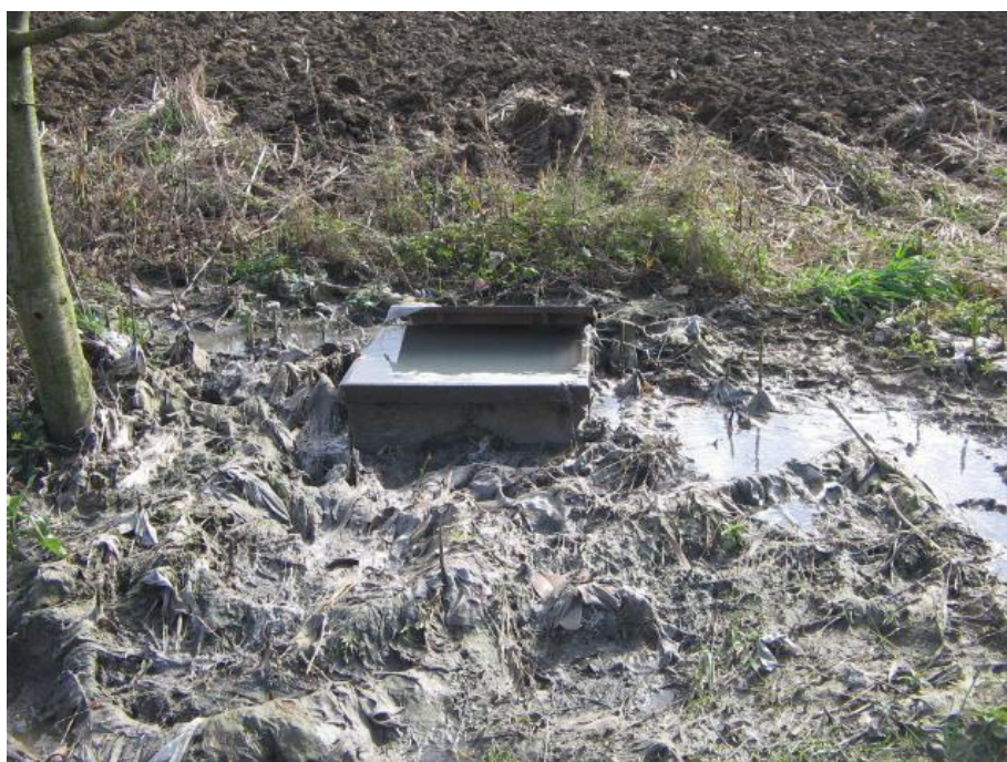
Arqueta con problemas de capacidad en la red actual
