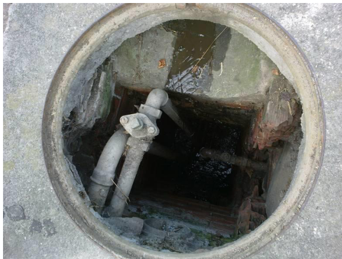
Arqueta de saneamiento con tubería de abastecimiento en su interior
