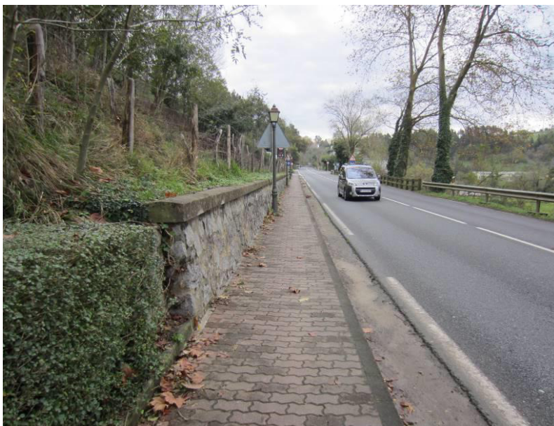
Acera existente en la N - 634
